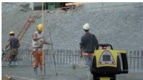
Coladas de hormigón
